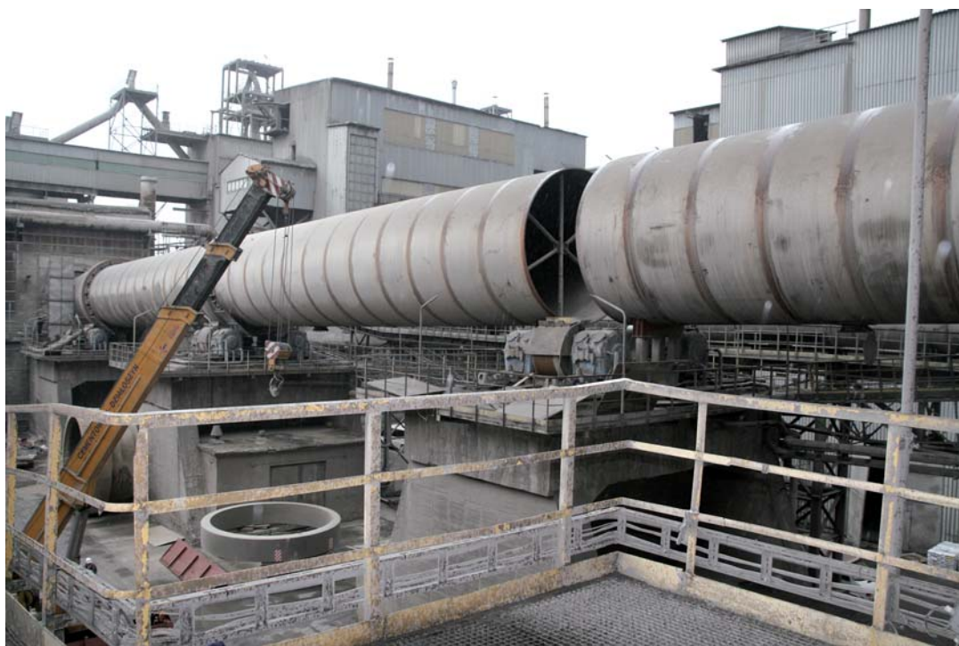
Główną inwestycją Cementowni Warta roku 2008 i 2009 jest rozbudowa linii technologicznej do produkcji klinkieru
